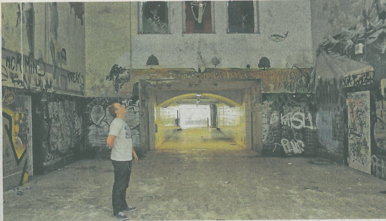
Skeptischer Blick bei einem Passanten: In der „Empfangshalle“ bröckelt der Putz von der Decke und das Dach ist kaputt. Fotos: Andreas Fischer
